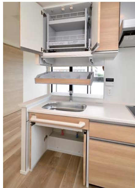
スイートルーム：ストック棚を下に引き出せる昇降キッチンラックの設置や高齢者の車いす利用に配慮したキッチン
