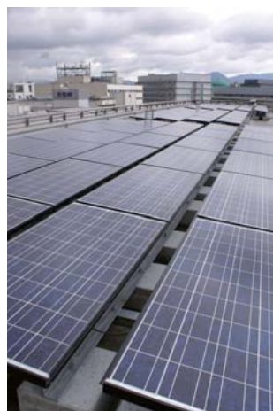
アーバンネット博多ビルの屋上に設置された太陽光パネル
